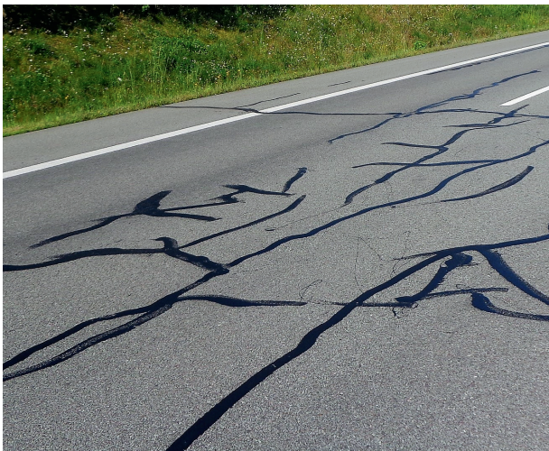
Vergossene Reflexionsrisse auf der BAB A20 (Quelle: Tensar International GmbH)
